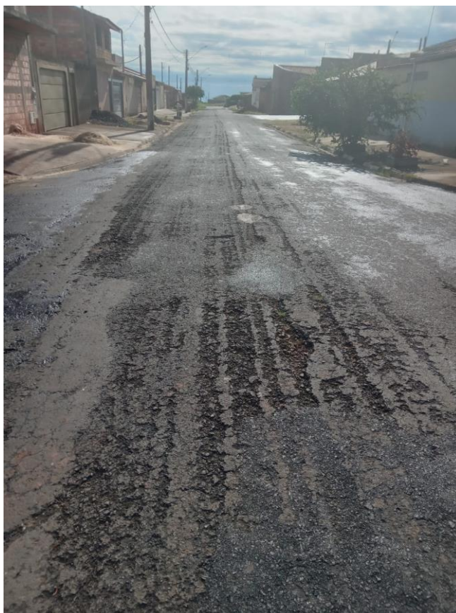
FOTO 03 – RUA ARLINDO SPIRLANDELLI, BAIRRO RES. ANDRE FRANCO MONTOURO
